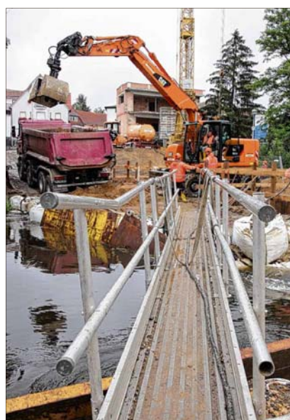
Über diese Behelfsbrücke können die Bauarbeiter zwischen Nord- und Südufer der Baustelle zu Fuß wechseln. Foto: Ariane Amann
