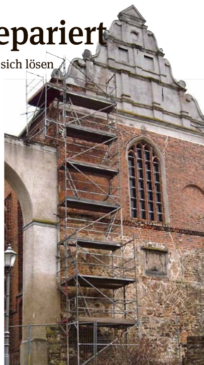
Dort, wo das Gerüst endet, sind am Giebel deutlich feuchte Stellen zu erkennen. Die können das Mauerwerk lösen. Foto: Gudrun Billowie
